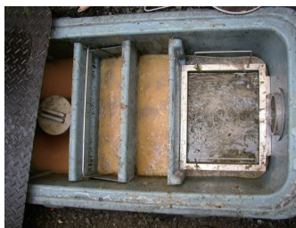
浄化槽・ グリストラップ
